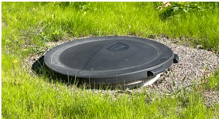
Lock på pumpstation.
